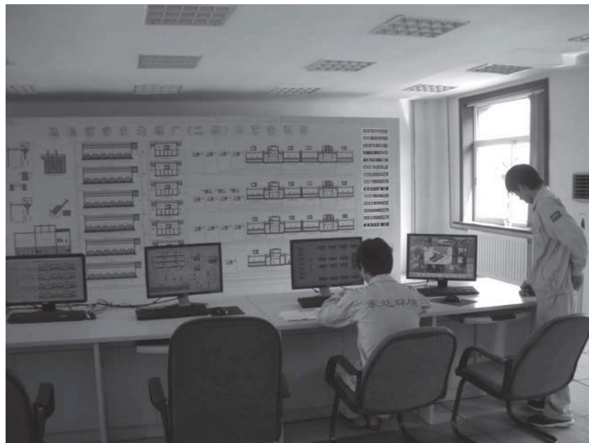
写真3 「馬欄河污水处理場二期」の制御室 — 24時間体制での管理体制— 撮影：佐藤 寛 2012年8月29日
