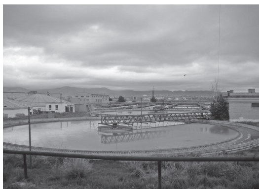
写真2 老朽化の中央下水処理場
