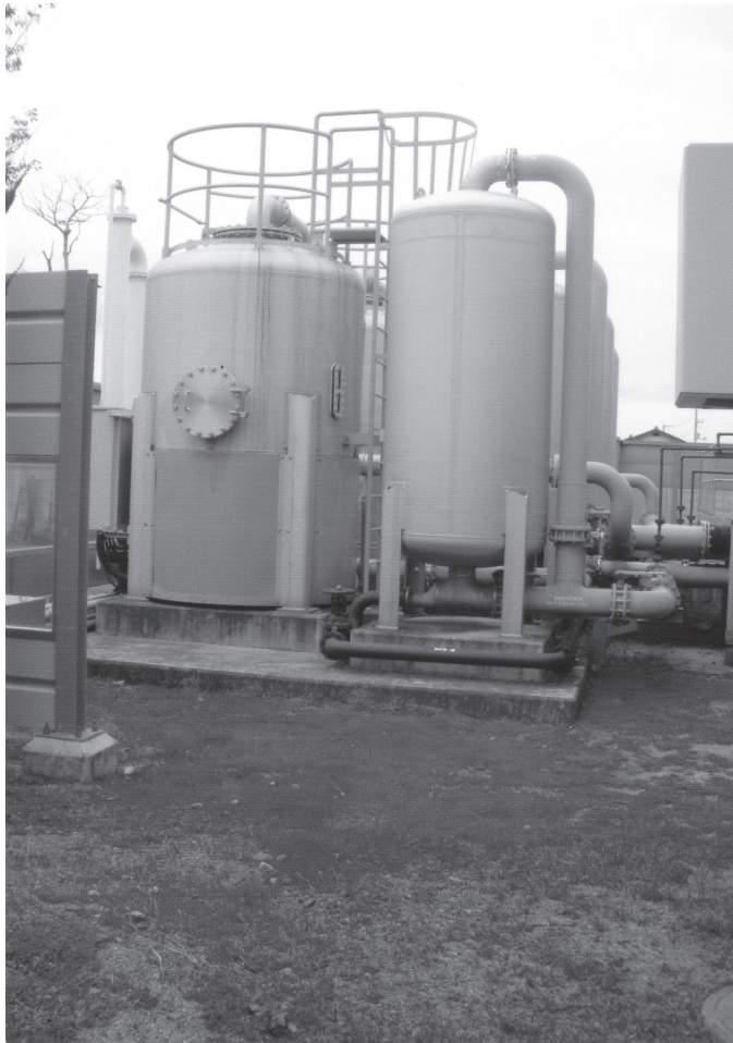
写真 2 水環境処理施設
